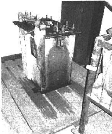
Figura N° 12: Transformadores de subestaciones presentan pérdidas y manchas de aceite tanto en equipos como en la instalación
