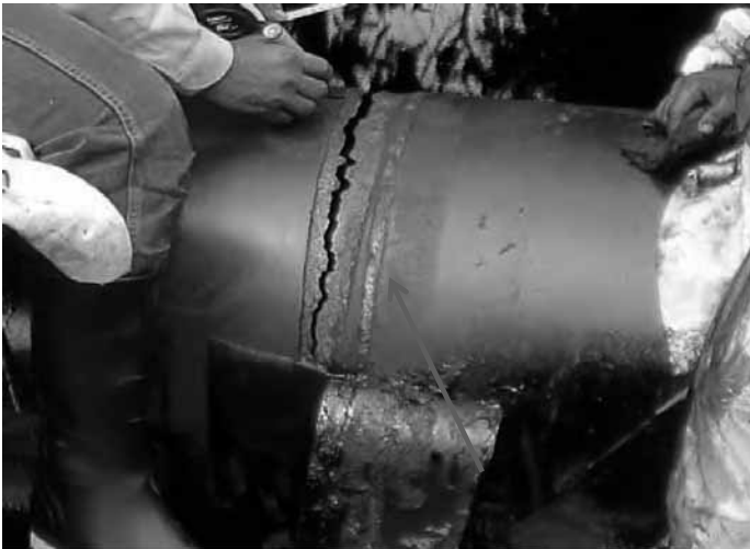
Foto N° 2 del 10 de julio de 2014 (segunda visita de supervisión). Se puede apreciar la falla (rajadura) del Oleoducto, punto donde se produjo el derrame, altura del km. 42 del Oleoducto Norperuano.
