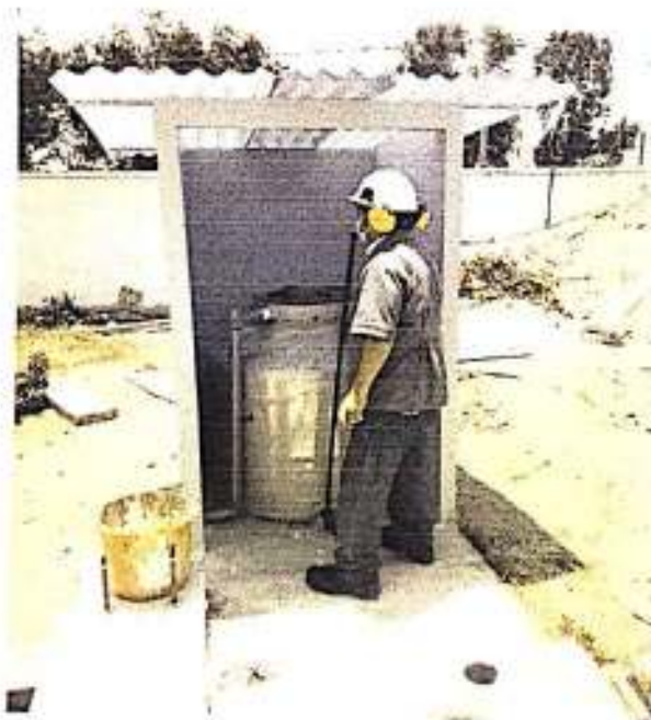
Foto 4: Vista de la implementación de la futura desinfección de las aguas residuales domesticas tratadas.
