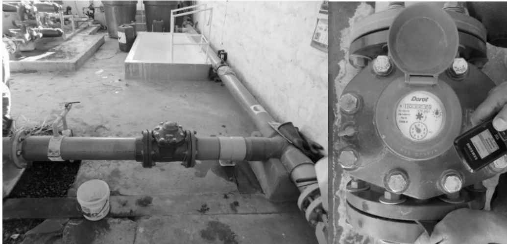
Imagen N° 2 Medidor tipo Woltman
