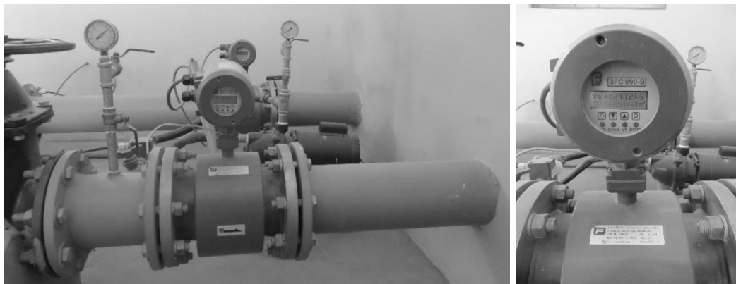
Imagen N° 5 Medidor tipo Electromagnético
