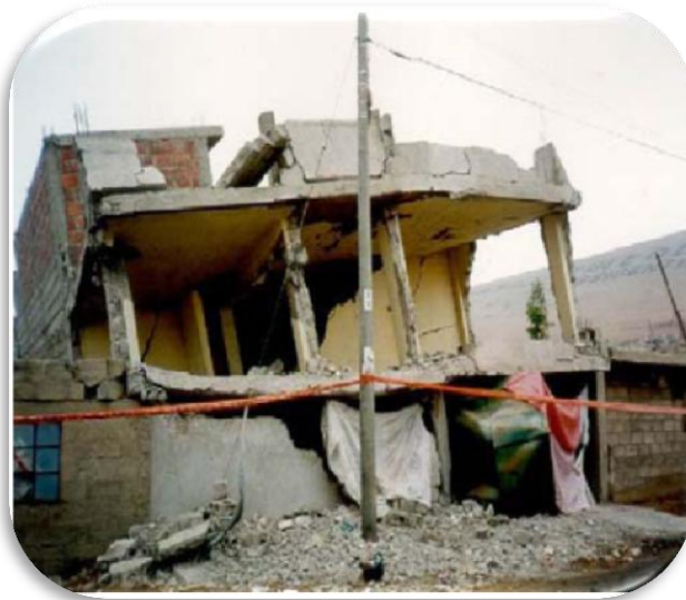
Vivienda colapsada en mal suelo Distrito de Ciudad Nueva
