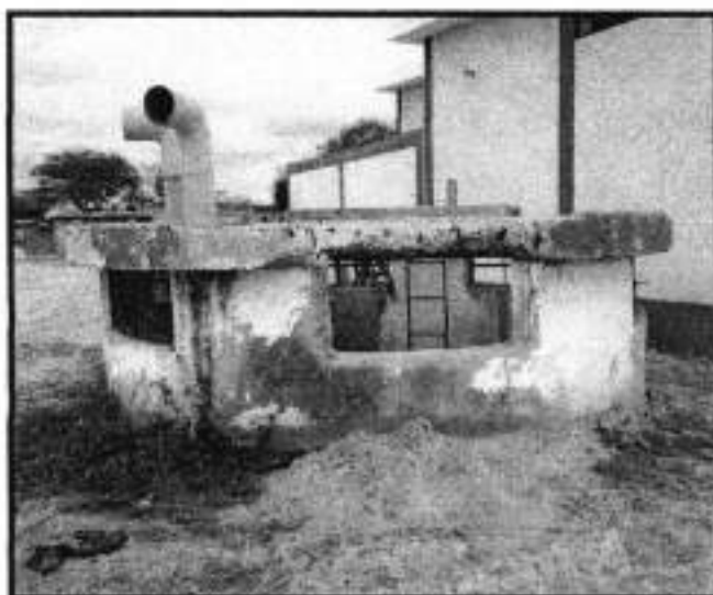
Foto N°5. Colector ubicado en la cámara de bombeo de las aguas residuales ubicado en la calle Manco Capac. AA. III. 28 de Julio. Aguas Verdes.
