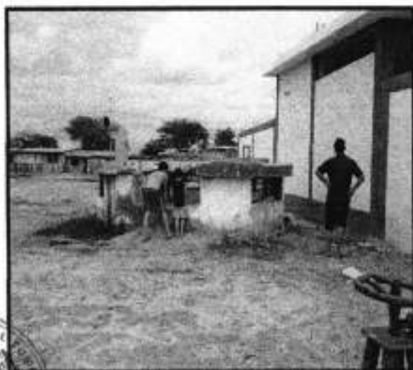
Foto N°6. Colector ubicado en la cámara de bombeo de las aguas residuales ubicado en la calle Manco Capac. AA. III. 28 de Julio. Aguas Verdes. Representa un riesgo para la población sobre todo los niños.
