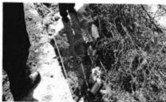
Foto N° 4. Aguas residuales que discurren a la quebrada ubicada en la parte posterior de Cámara de Bombeo Caleta Grau.
