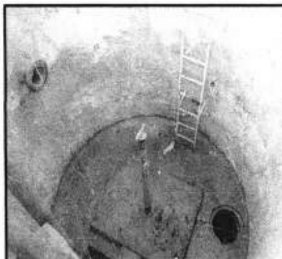
Foto N°7. Colector ubicado en la cámara de bombeo de las aguas residuales ubicado en la calle Manco Capac. AA. III. 28 de Julio. Aguas Verdes.
