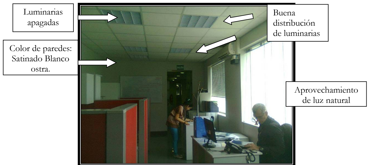
Foto N° 1: Medidas de Ecoeficiencia en Iluminación – Oficinas MINAM sede central
