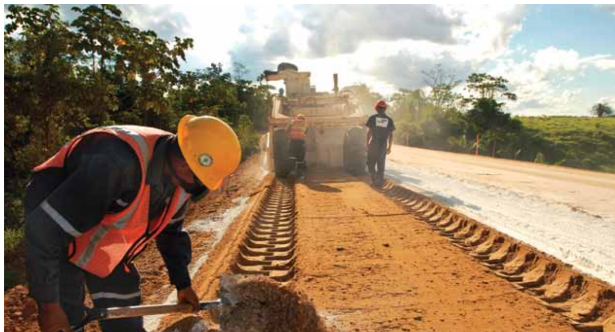
Trabajos para la construcción de la Carretera Interoceánica, Puerto Maldonado (Madre de Dios).
