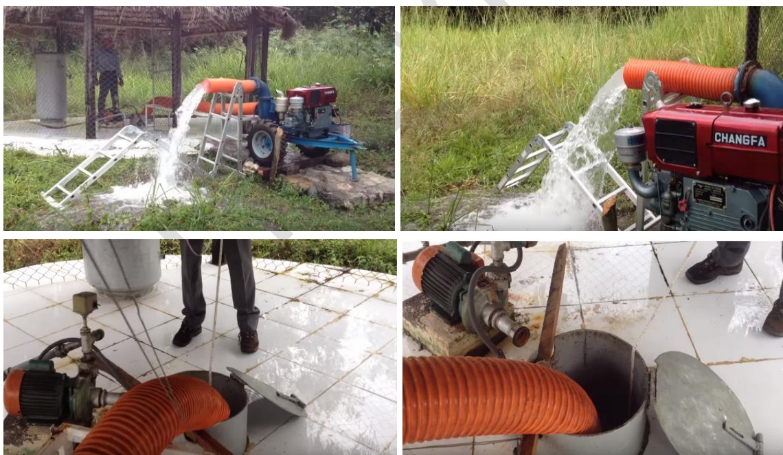
Figura 165. Mediciones de caudal bombeado y mediciones del nivel para una prueba de bombeo. Fuente: https://www.youtube.com/watch?v=-S6Gm9LZxTI . Prueba de bombeo Pozos con bomba de 50 litros por segundo.
