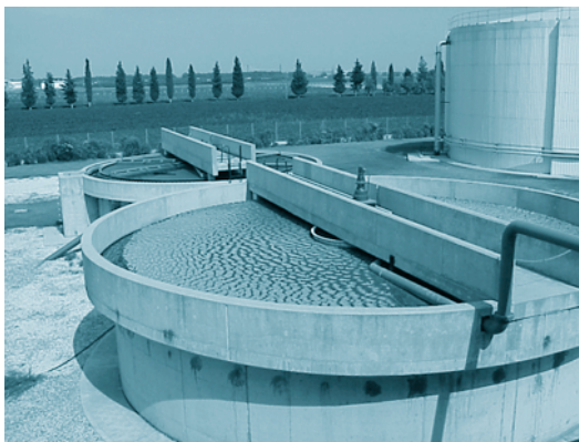
FOTOGRAFÍA 19. Espesadores de lodos, por gravedad y por flotación.
