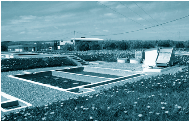
FOTOGRAFÍA 1. Instalación de tratamiento mediante filtro de turba, en la que se observa el tamiz autolimpiante, ubicado sobre un desengrasador estático, y los filtros de turba.
