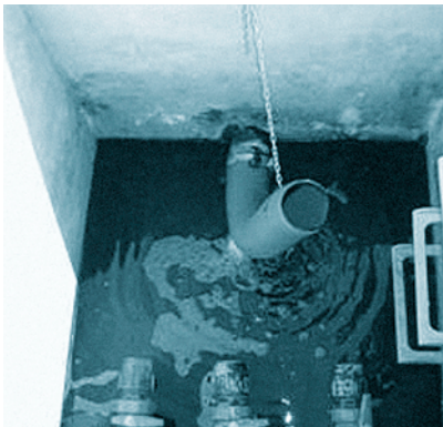
FOTOGRAFÍA 9. Tubería de evacuación de efluentes, conectada a las tuberías de drenaje. Al ser flexible permite controlar el nivel del agua en el sustrato filtrante.
