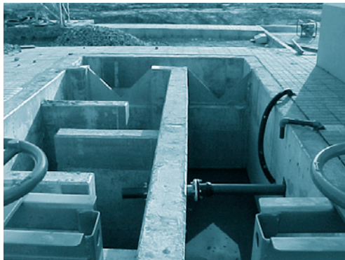
FOTOGRAFÍA 12. Medición de caudal en vertedero triangular.
