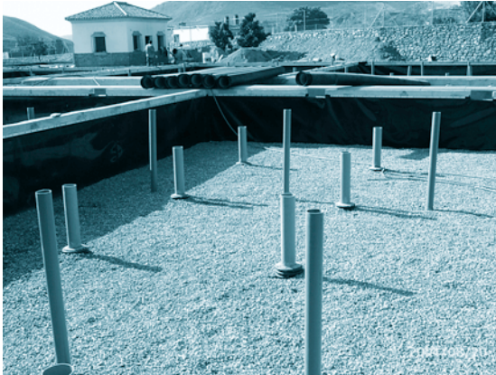
FOTOGRAFÍA 7. Chimeneas de ventilación del sustrato filtrante.
