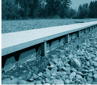
FOTOGRAFÍA 16. Reparto de la alimentación a un HAFSs horizontal mediante vertedero Thompson. (EDAR de Corbins, Lleida)
