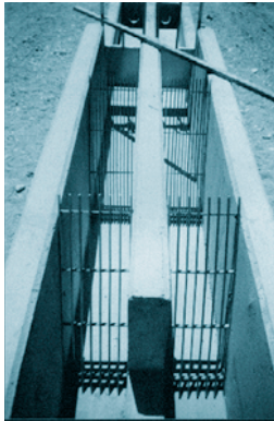
FOTOGRAFÍA 3. Desbaste de gruesos seguido de desbaste de finos, empleando rejas rectas de limpieza manual.
