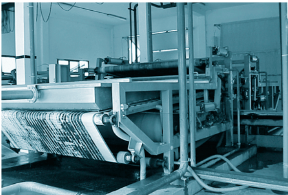
FOTOGRAFÍA 23. Deshidratación de lodos mediante Filtro banda.
