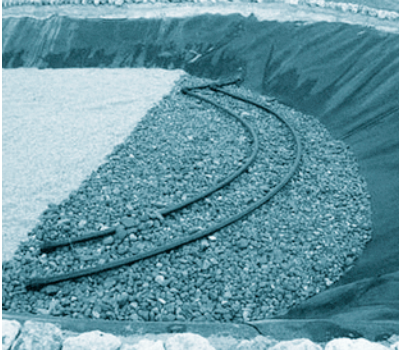
FOTOGRAFÍA 15. Tuberías de reparto en un HAFSs horizontal (PECC)
