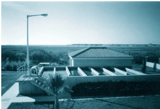
FOTOGRAFÍA 18. Laberinto de cloración.
