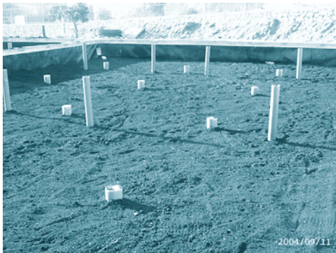
FOTOGRAFÍA 9. Turba ya colocada, se aprecian las chimeneas de alimentación y los soportes (tubos cortos) para las tuberías de reparto.
