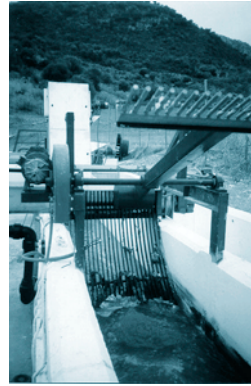
FOTOGRAFÍA 4. Reja curva de accionamiento automático.
