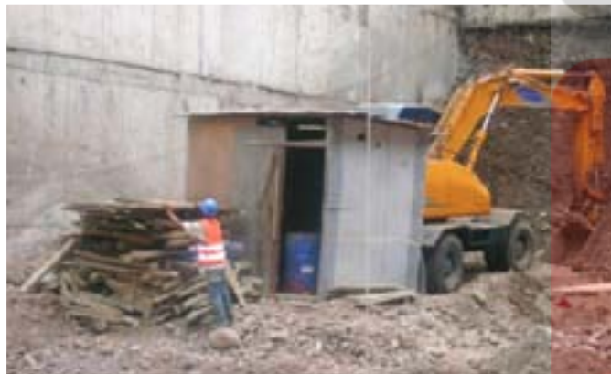
Foto 17. Almacén en zona de riesgo
