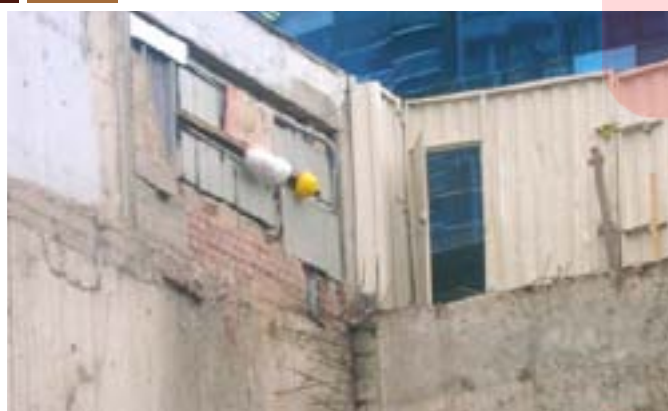
Foto 18. Extensión del vestuario en zona de riesgo
