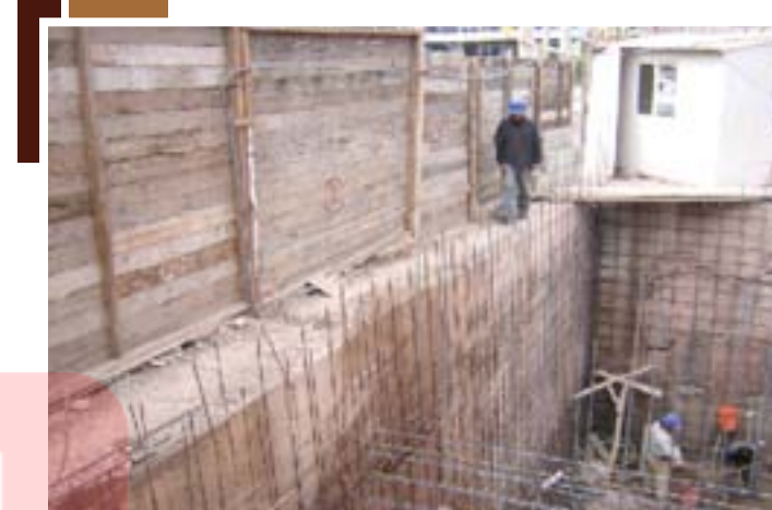
Foto 19. Oficina y accesos inadecuados
