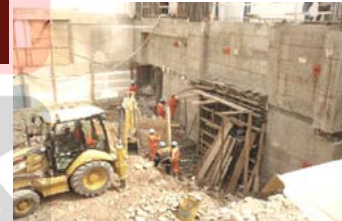
Foto 15. Muro anclado (pantalla)
