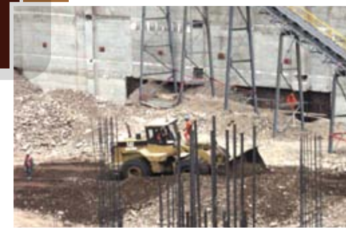
Foto 16. Muro anclado (pantalla)
