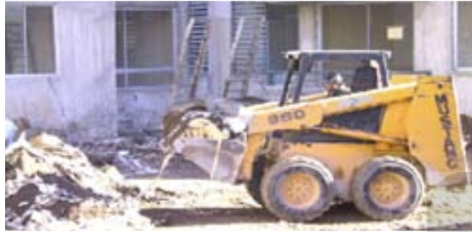
Foto 22. Uso de maquinaria pesada sin señalización
