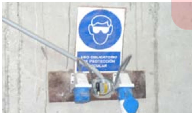
Foto 30. Señalización acorde a los peligros
