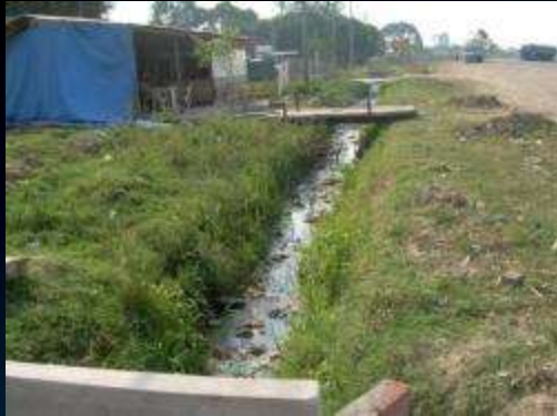
DESCARGA DIRECTA DE AGUAS SERVIDAS A LA CALLE
