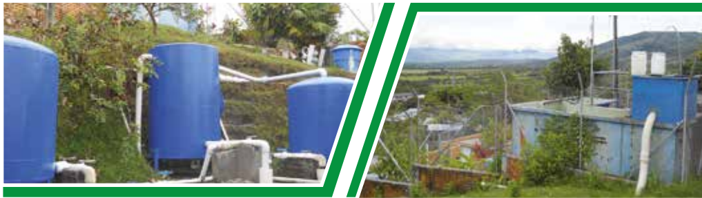
● Corregimiento Costa Rica-Ginebra V. Quebrada Vanegas Planta de Tratamiento PTAP
