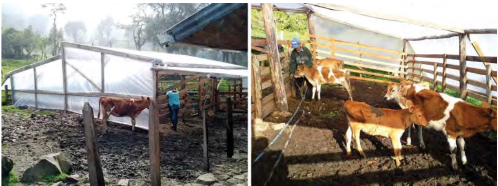
Figura 6. Proceso de construcción de un encierro invernadero para ganado. Fotos: Daniel Corrales-Gutiérrez, Panthera Costa Rica.
