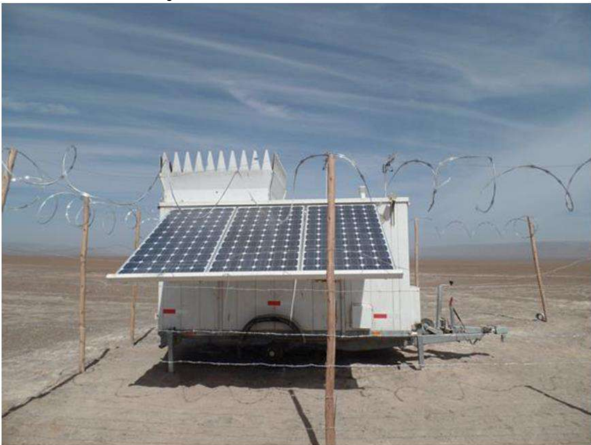
Figura 69. Sistema de medición remota SODAR.
