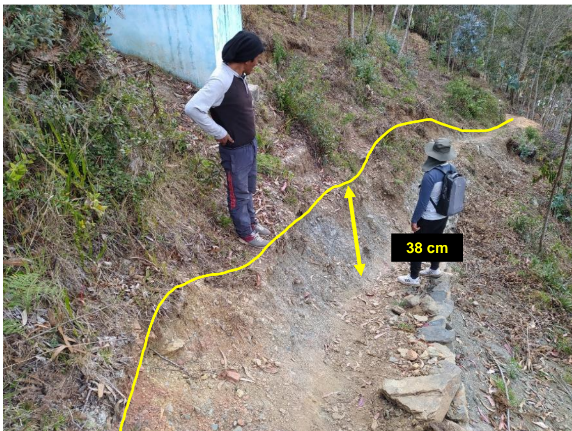
Figura 10. A. Agrietamiento de 38 cm de desnivel (UTM E: 450354, N: 8413493).
