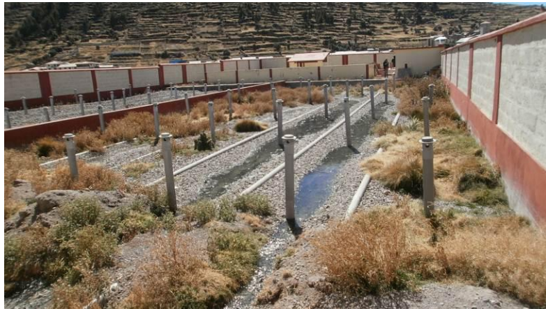
Foto N° 06 Planta de Tratamiento de Aguas Residuales de la Población de Chupa – Azángaro (Intercuenca Ramis)
