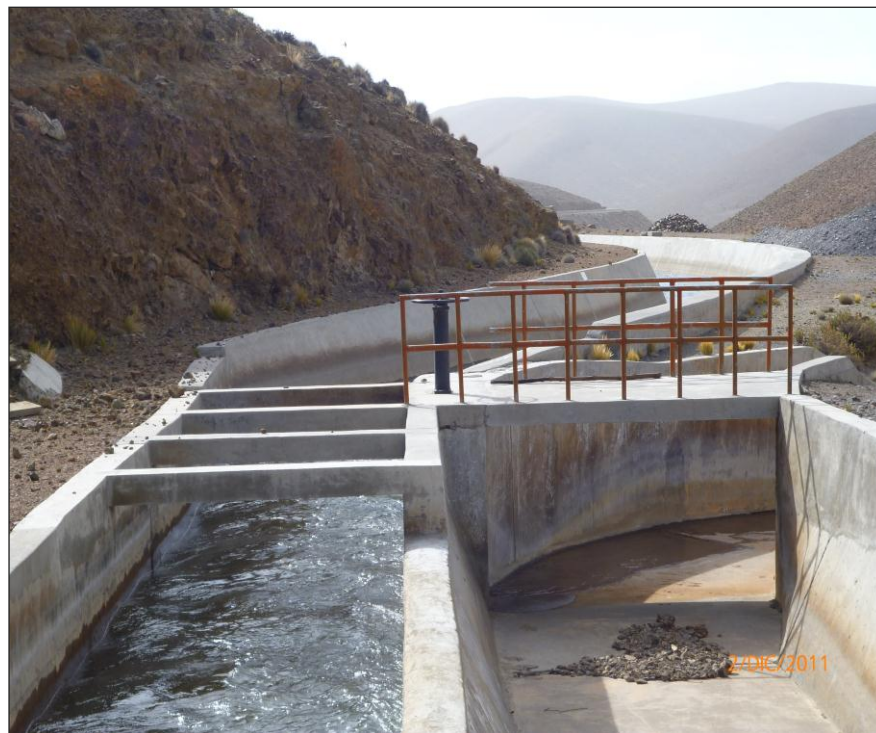
Bocatoma Challapunco – Sistema de descarga de embalse Pasto Grande.
