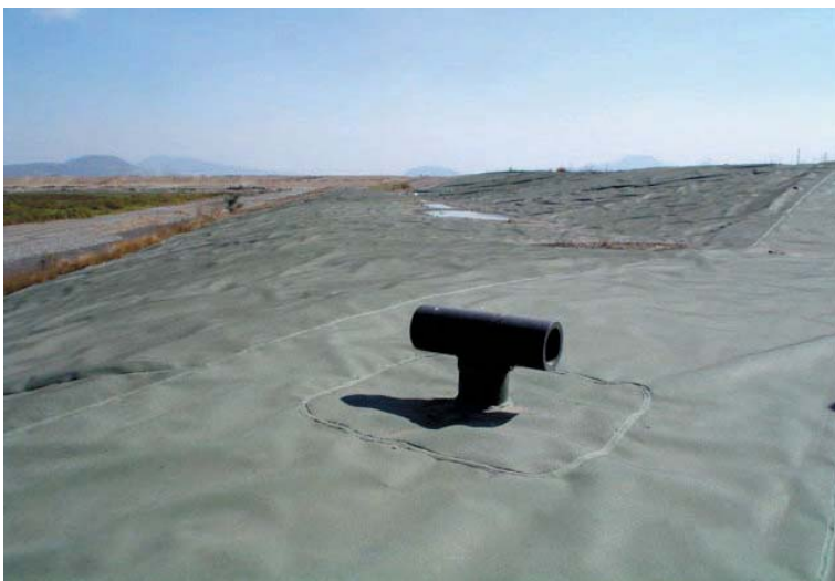
Relleno Sanitario Bordo Poniente. Celda clausurado con tubo de venteo de gases.
