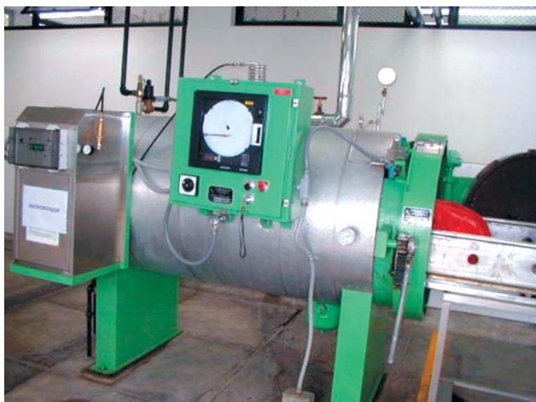
Módulo de Residuos Hospitalarios. Hospital Nacional de Collique. Autoclave para residuos hospitalarios
