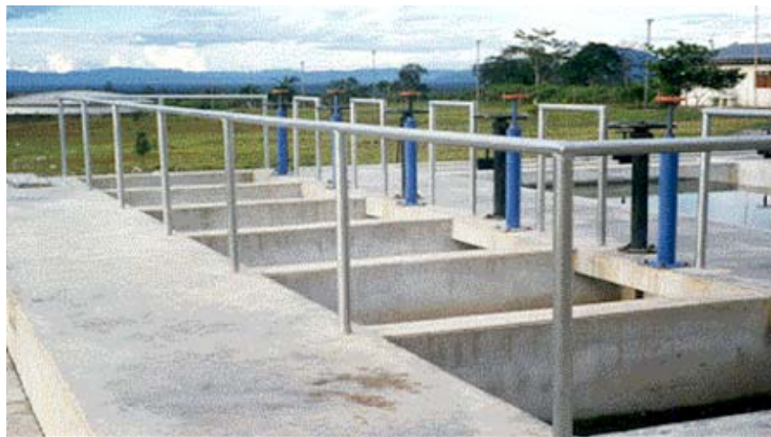
Figura A.7.3 Batería de filtros de tasa declinante y lavado mutuo
