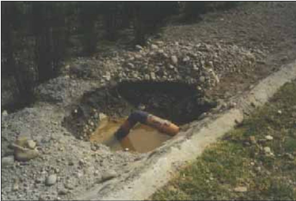
Figura 11: Pruebas hidráulicas, en la fotografía se observa el tubo de conexión al sistema principal ya reparado antes de colocar las cajas de distribución e inspección con cierre candados.
