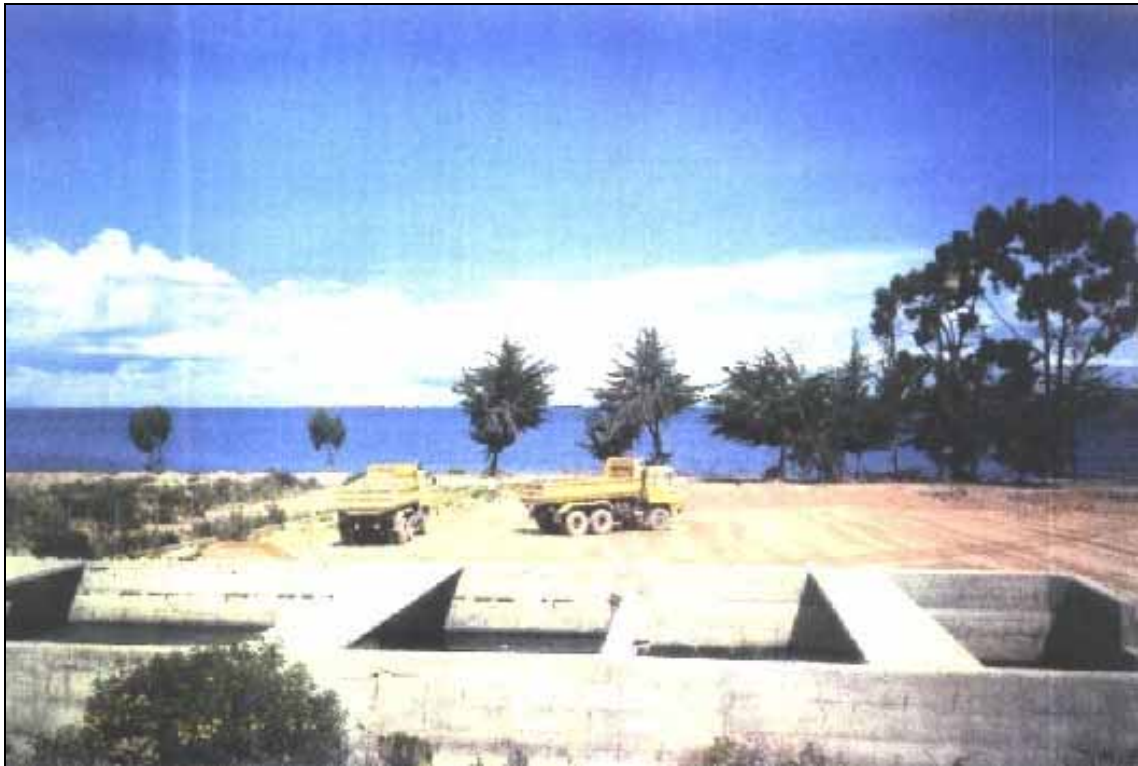
4. Transporte y acumulación de tierra a la base del sistema de tratamiento.
