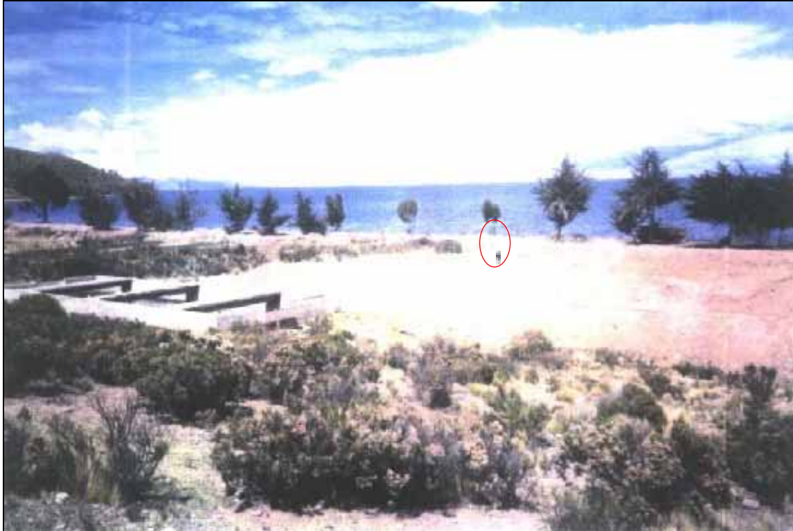
8. Construcción de los terraplenes y de las celdas de tratamiento. Nótese la altura de los mismos comparado con la altura de una persona.
