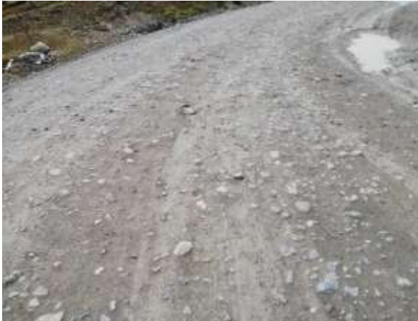
Nota: Gran parte del tramo de afirmado, ha perdido el material de afirmado.
