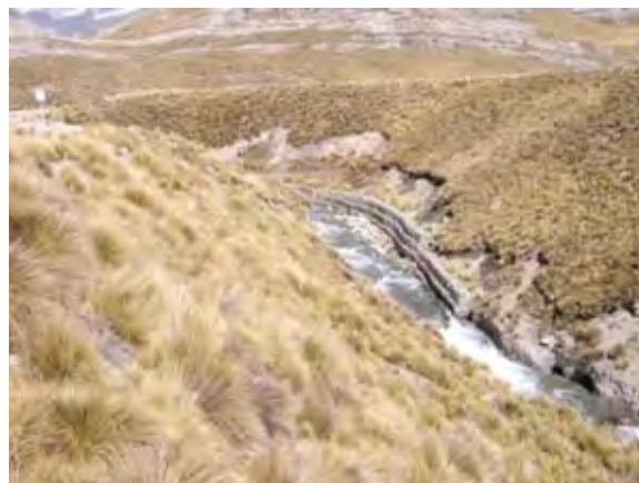
Figura 2.6: Canal de desagüe de la presa Carhuacocha, destacando procesos de origen hídrico con erosión regresiva en la base de los taludes.
