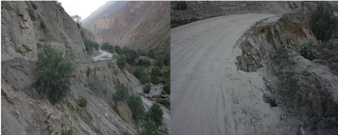
Vistas de la erosión formada en el km 103+650
