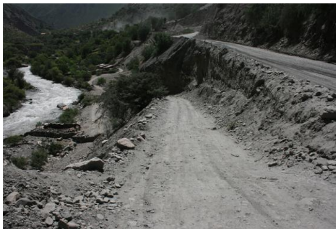
Plataforma de carretera desestabilizada por corte para acceso
