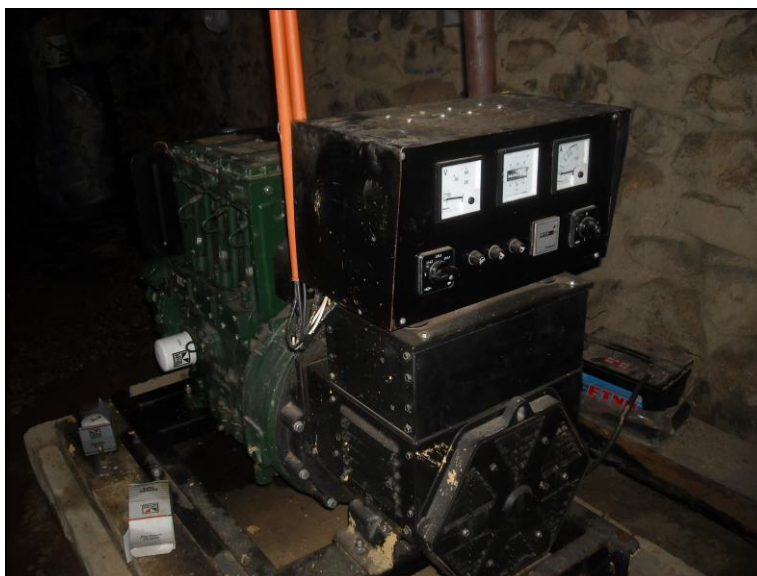
Figura N° 6. 1 Generador Eléctrico en el campamento Paraj
