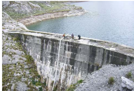
Ilustración 6. Elemento de regulación en la Laguna Quisha. Subcuenca de Baños.
