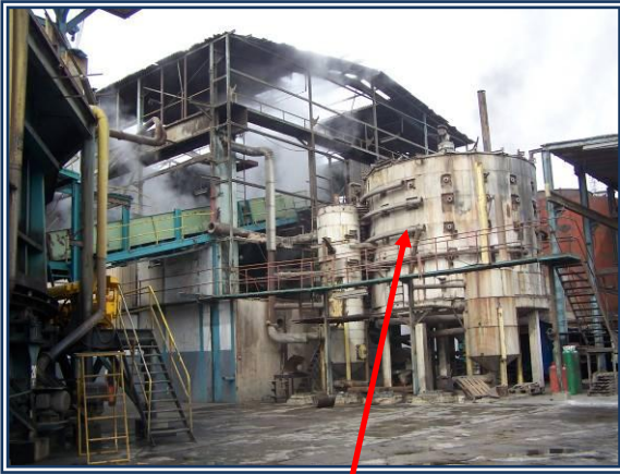
Equipos sin mantenimiento
