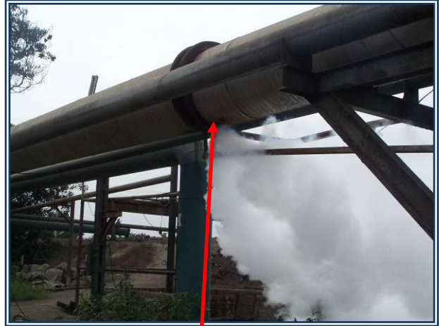
Fugas de vapor
