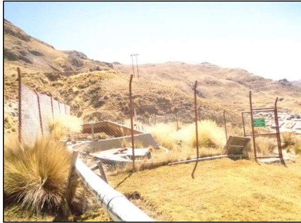
Fotografía N° II - 44: Poza de Circulación
