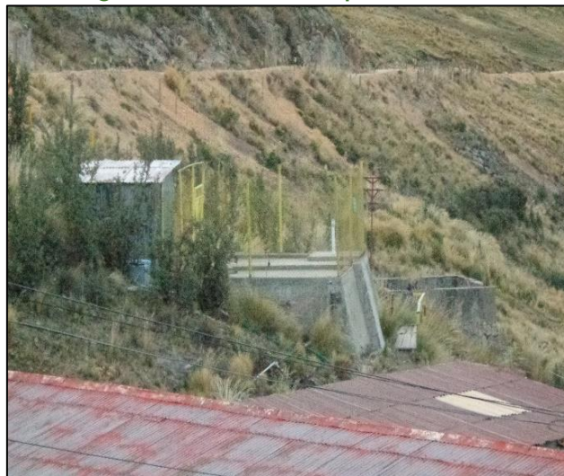
Fotografía N° II - 50: Tanques de Concreto
