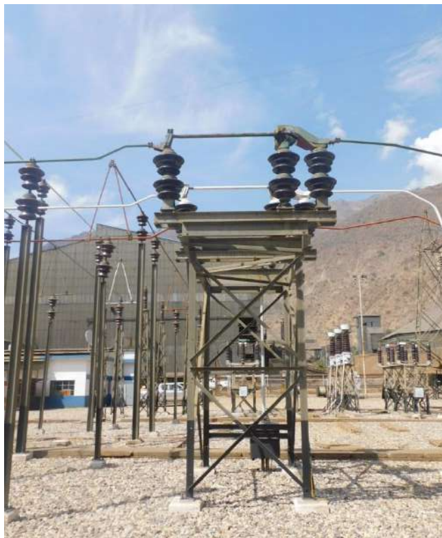
Fotografía 3.3-27 Vista de Seccionador de barra en 72.5 kV.
