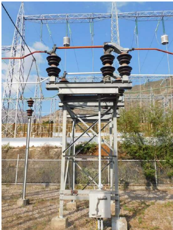
Fotografía 3.3-9 Vista de Seccionador de barra en 72.5 kV
