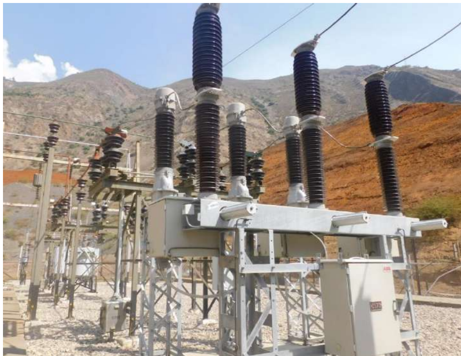
Fotografía 3.3-25 Vista de Interruptor de potencia en SF6 en 72.5 kV
