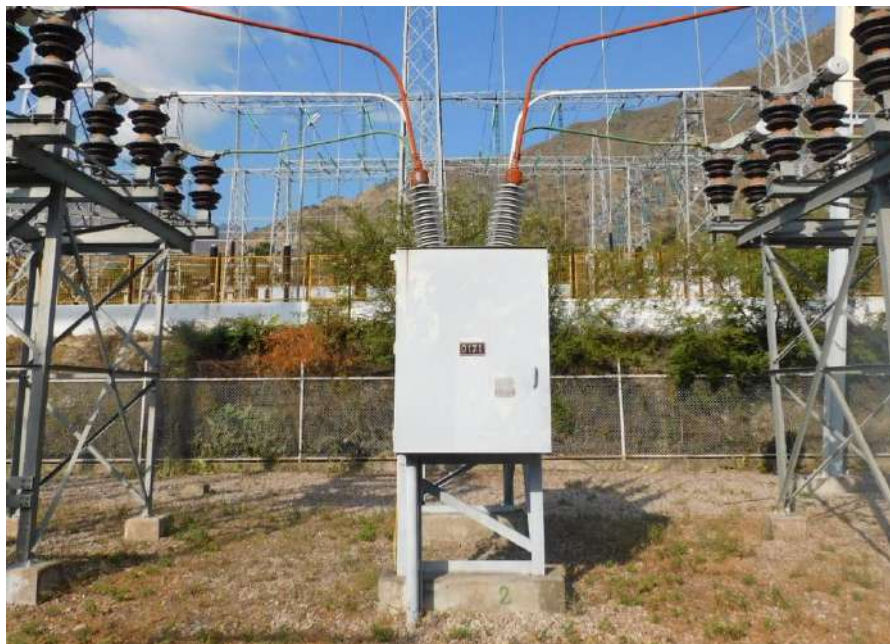
Fotografía 3.3-7 Vista de Interruptor de potencia de 72.5 kV
