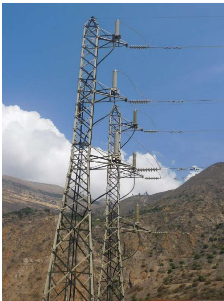
Fotografía 3-2 LT 69 kV de llegada a S.E. Cobriza II desde S.E. Cobriza I
