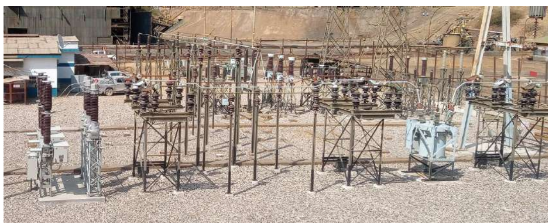
Fotografía 3.3-23 Vista de Patio de Llaves
