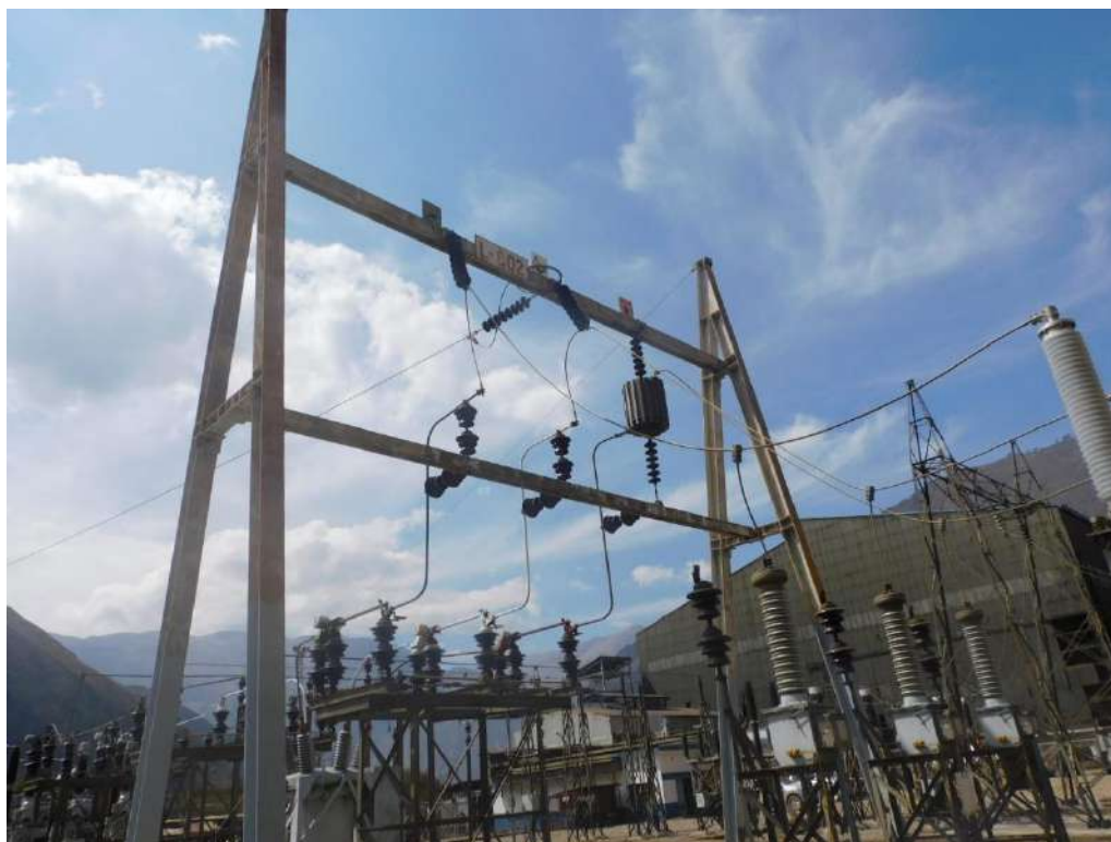
Fotografía 3-1 Pórtico de llegada de LT 69 kV S.E. Cobriza II desde Cobriza I
