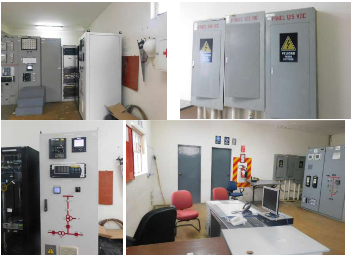
Fotografía 3.3-11 Vistas de interiores de Sala de Control
