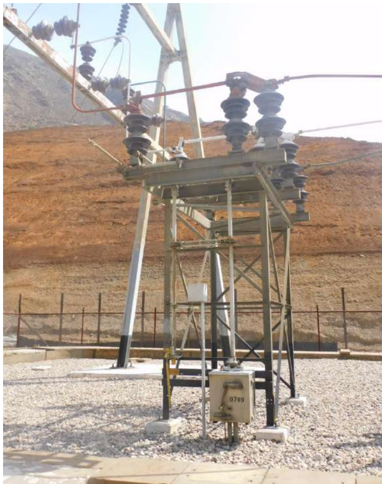
Fotografía 3.3-26 Vista de Seccionador de línea de 72.5 kV
