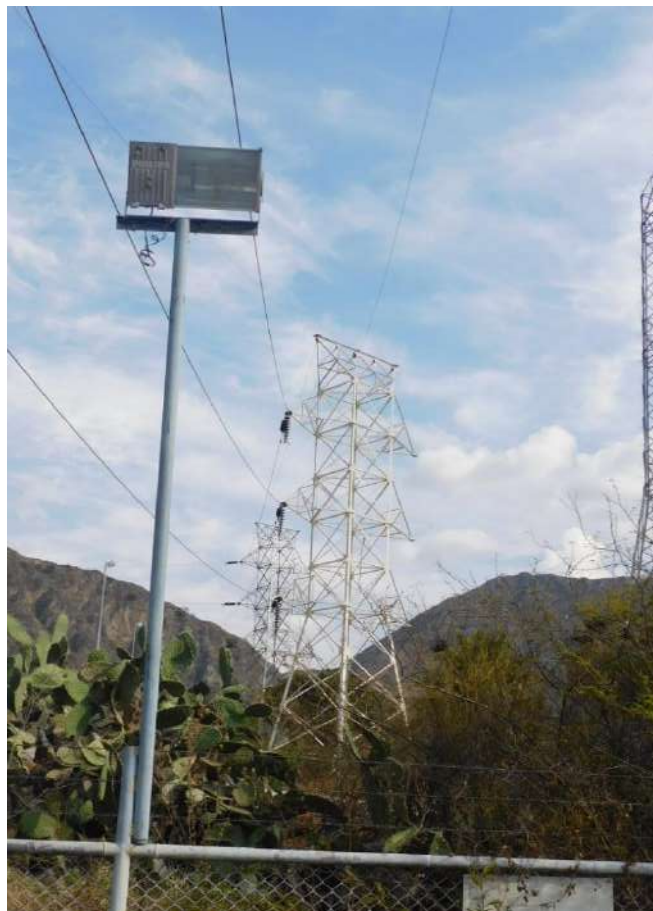
Fotografía 3-2 LT 69 kV de salida desde S.E. Cobriza I hacia S.E. Cobriza II
