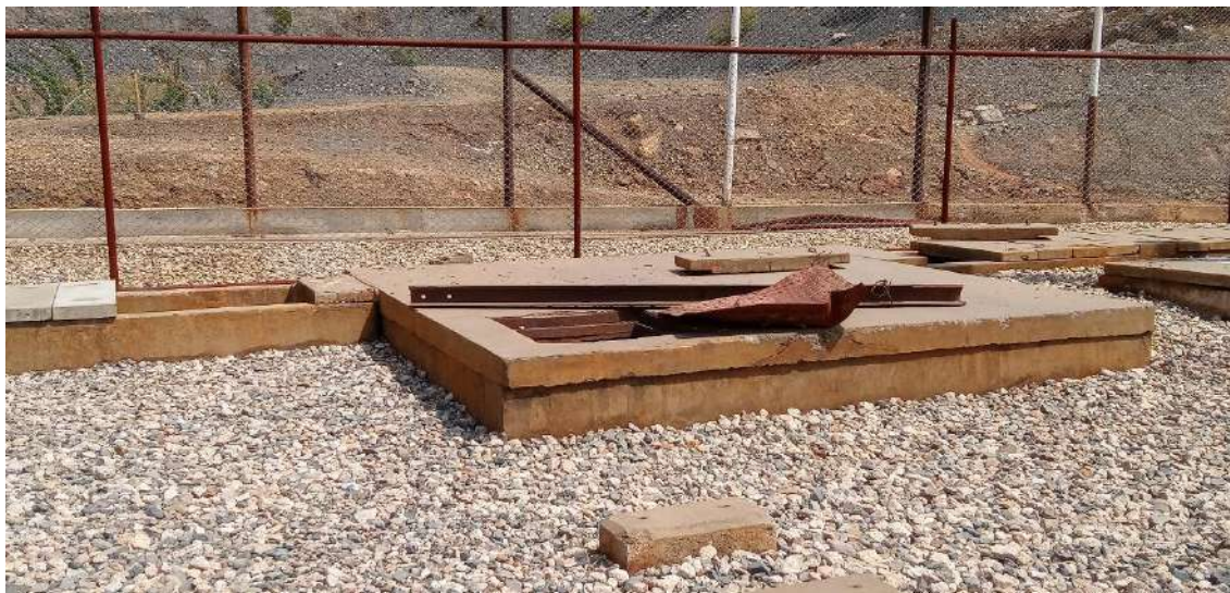
Fotografía 3.3-32 Vista exterior de caja de pase
