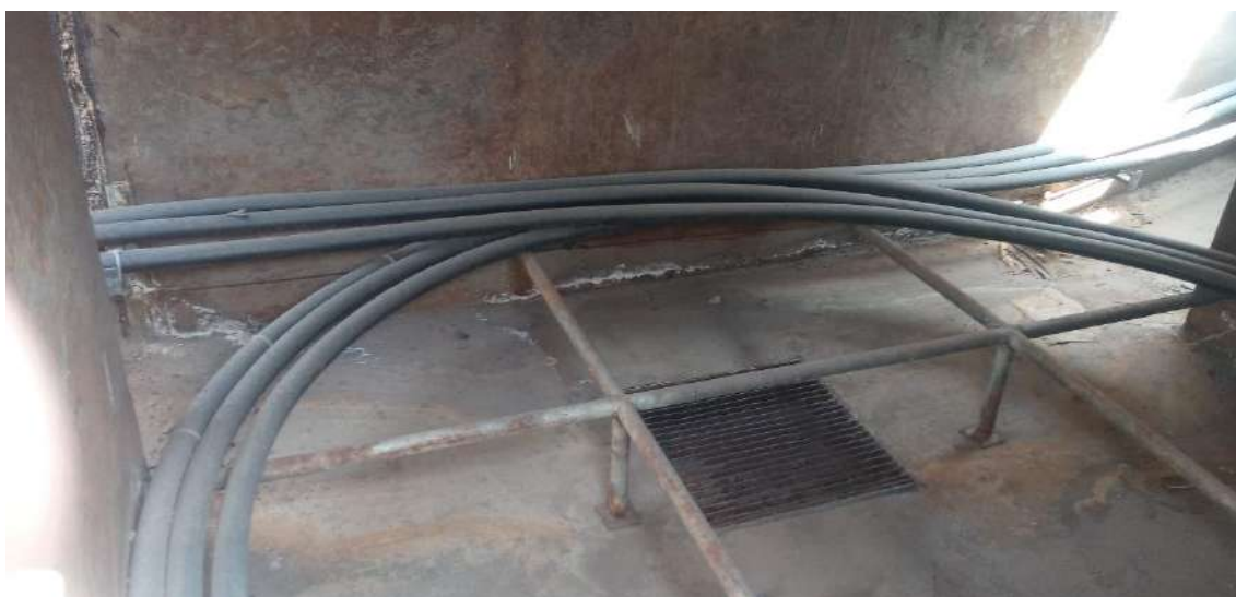
Fotografía 3.3-33 Vista interior de caja de pase
