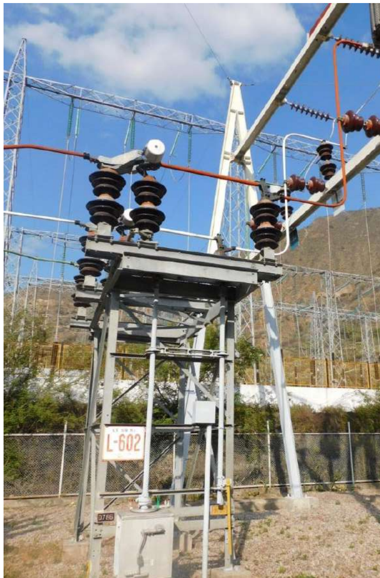
Fotografía 3.3-8 Vista de Seccionador de línea en 72.5 kV.
