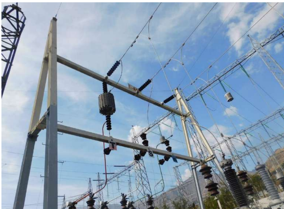
Fotografía 3-1 Pórtico de salida de LT 69 kV S.E. Cobriza I – Cobriza II
