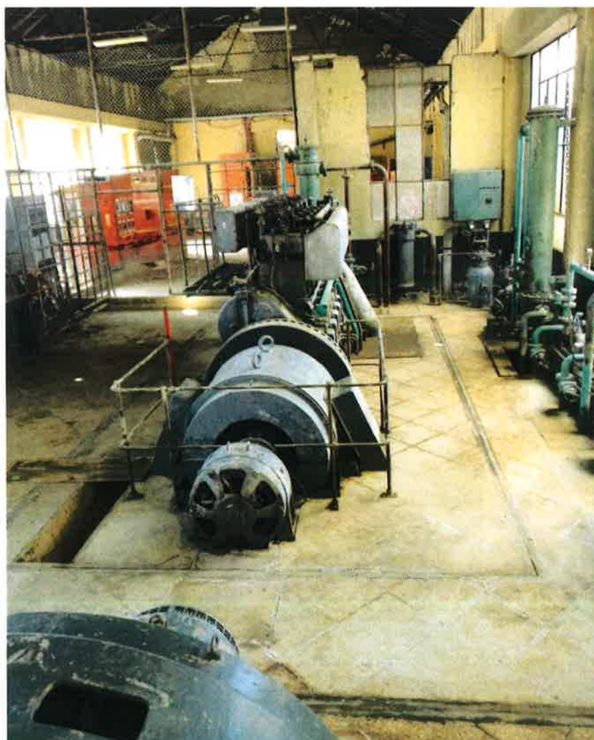
FIGURA 2. Central Térmica Caudalosa Grande
