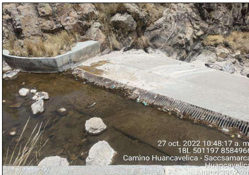
Foto: Bocatoma de captación en el río Sacsamarca
