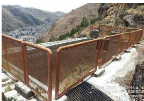
Figura 6.50. Tramo entre el cuarto puente de acceso peatonal y área de cámara de carga.
