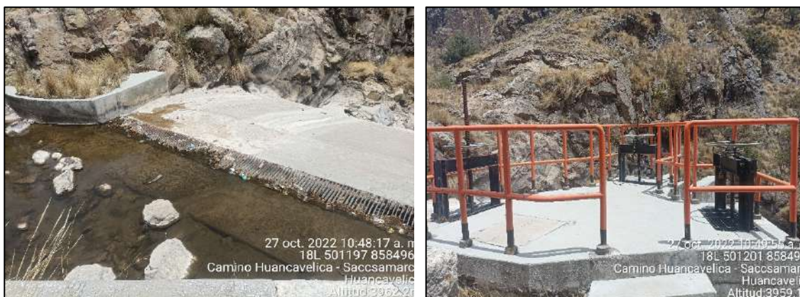
Figura 3.4. Rejilla de captación y Compuertas metálicas
