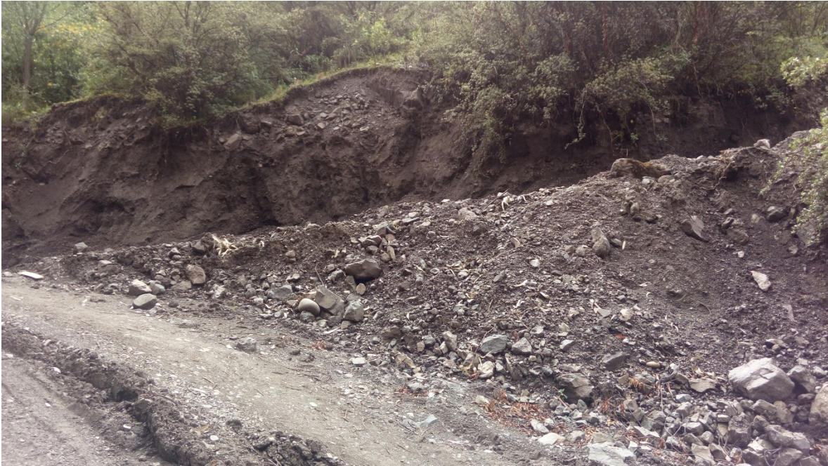
Zona donde se implementara el proyecto , via de acceso hacia donde se ubicará la zona de almacenamiento de material no metalico y zona donde se ubicara la chancadora de quijada
