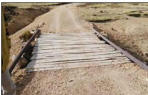
Fotografía N° 3.8. Vista del tablero
