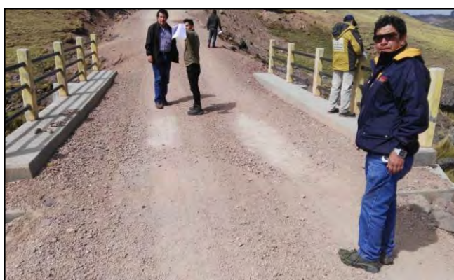
Fotografía N° 3.6. Vista del tablero
