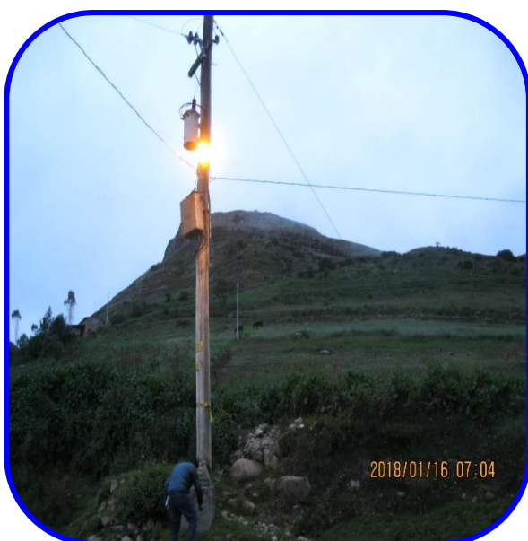
REGISTRO N° 05: Instalaciones eléctricas existentes las cuales requieren ser mejoradas y/o remodeladas.
