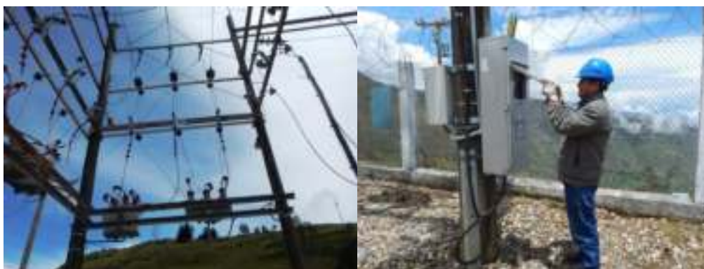
Gráfico N° 08. Equipos en lado de 13.2 kV
