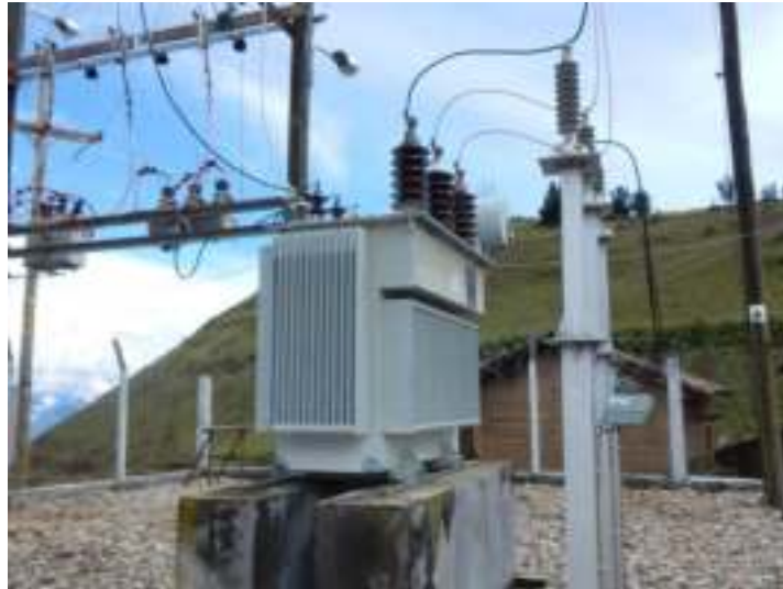
Gráfico N° 05. Transformador de Potencia
