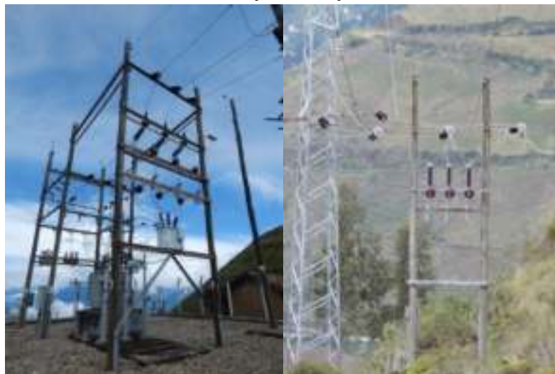
Gráfico N° 01. Subestación Huancayoccasa y estructura de derivación N° 27
