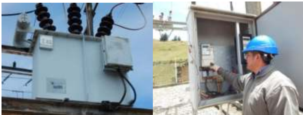
Gráfico N° 07. Equipos de medición lado 33 kV
