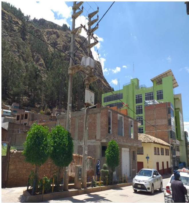
Vista del punto de entrega para el sistema de utilización en 10kv de la sede institucional de la DIRECCIÓN REGIONAL DE EDUCACIÓN DE HUANCVELICA.
