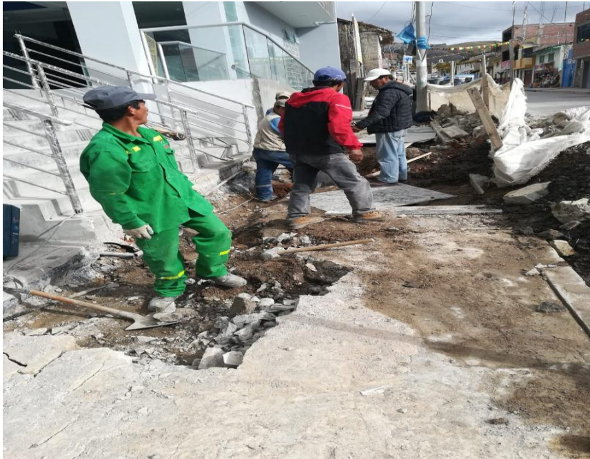
Foto N° 3: Ubicación donde se Ubicada el Transformador
