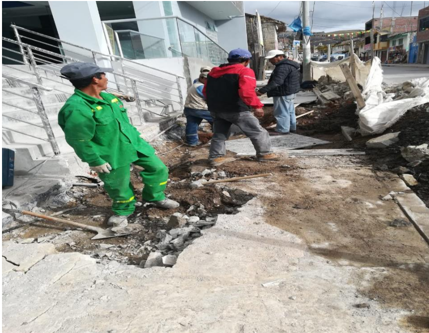
Foto N° 3: Ubicación donde se Ubicada el Transformador
