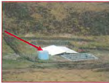
FOTOGRAFIA N° 151 Planta de tratamiento de agua residual modelo INJOF.
