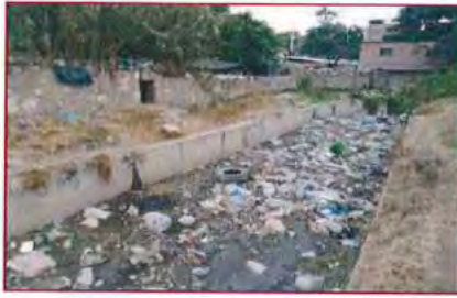
FOTOGRAFIA N° 168 Quebrada seca con acumulación de residuos sólidos y vertimientos domiciliarios (Sector Chaquihuaycco)
