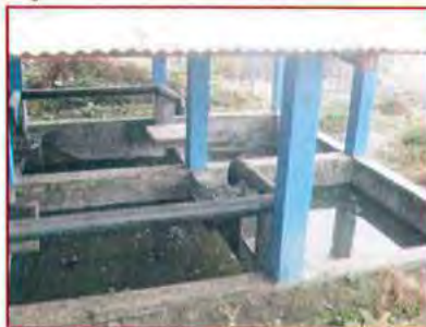
FOTOGRAFIA N° 153 Planta de tratamiento de agua residual modelo INJOF.
