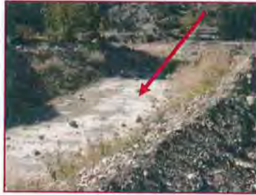
FOTOGRAFIA N° 109 Pozo séptico de la población de Huarisca.
