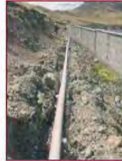
FOTOGRAFIA N°24 Desvío de las aguas residuales, por el perímetro de la Laguna de Oxidación
