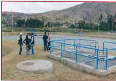
FOTOGRAFIA N° 170 PTAR Totorilla (EPSASA Ayacucho) sin autorización de
