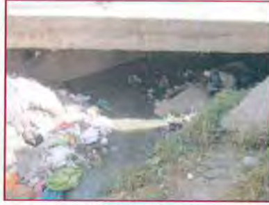
FOTOGRAFIA N° 58 Presencia de residuos sólidos domésticos en el canal.
