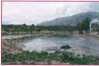
FOTOGRAFIA N° 174 PTAR ICHPICO (EPSASA – Huanta) pozas colmatadas con lodos
