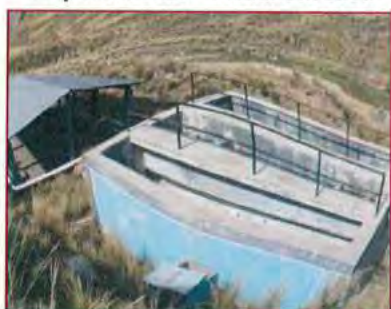
FOTOGRAFIA N° 183 Planta de Tratamiento de la localidad de Huachucolpa
