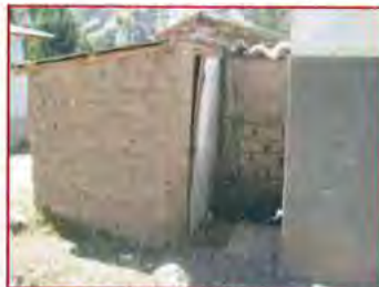
FOTOGRAFIA N° 136 Letrinas del distrito de Chacapampa
