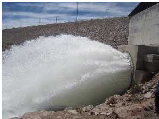
Compuerta de descarga de embalse de Pillones
