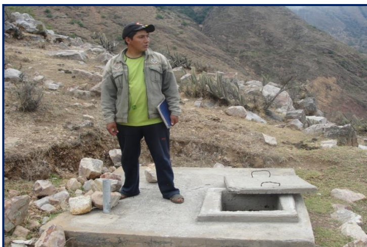
Fotografía: Captación de Agua entubada
