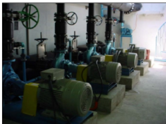
Fig. N° 30: Sala de Bombas centrífugas
