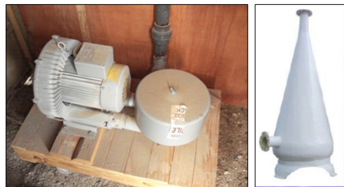
Fig. N° 24: Blower centrífuga y cono de sobresaturación
