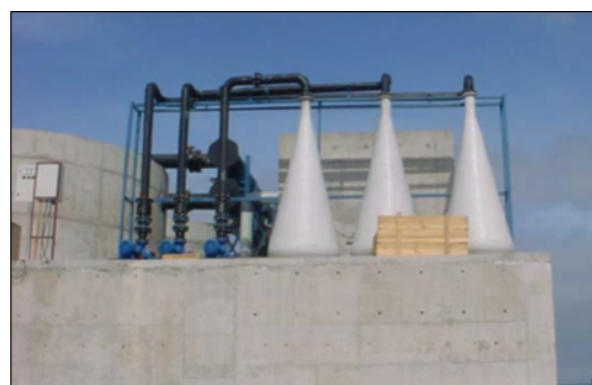
Fig. N° 32: Sistema de oxigenación de conos de sobresaturación
