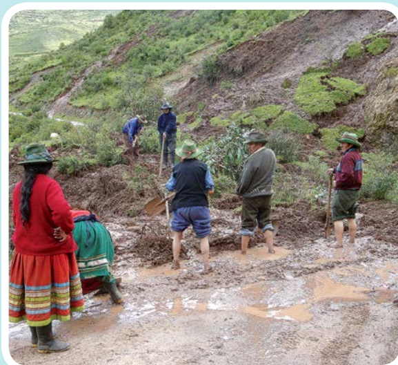
Los huaycos destruyen carreteras, aíslan a la población y afectan la economía, principalmente de los más pobres (PACC Perú).
