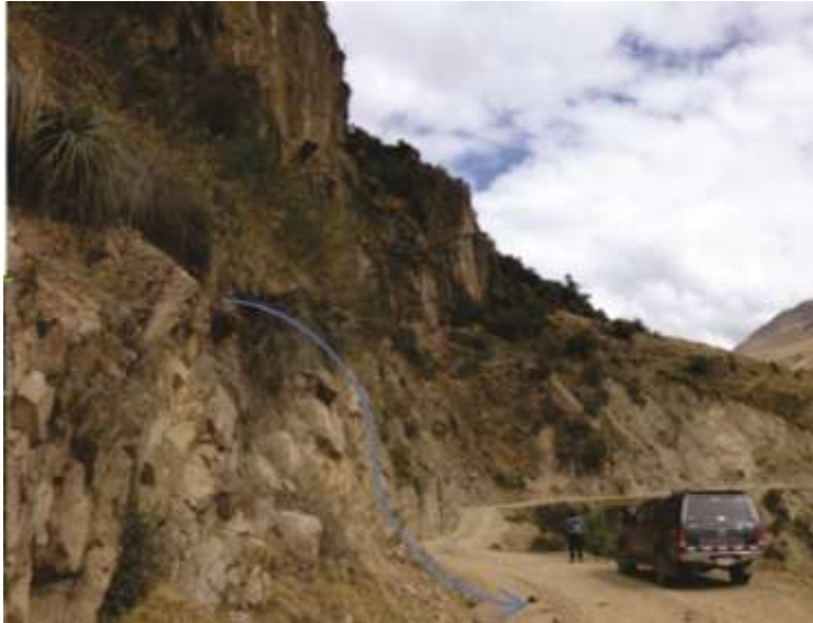
Foto 1. Caída de rocas en la margen derecha del río Huiriquilla, en el distrito de Curasco, provincia de Grau. Se observan los fragmentos suspendidos en el talud sobre la carretera.
