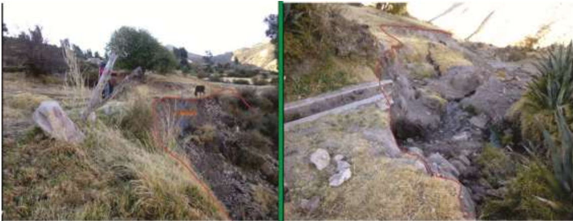
Fotos 6 y 7. Se observa un canal de agua roto en el cuerpo del deslizamiento de Cconchayoc (Anexo Ccayao, distrito de Haquira).
