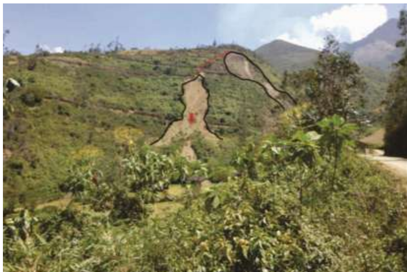
Foto 4. Dos derrumbes sucesivos en el sector Mitanay, que pueden dar origen a un deslizamiento.
