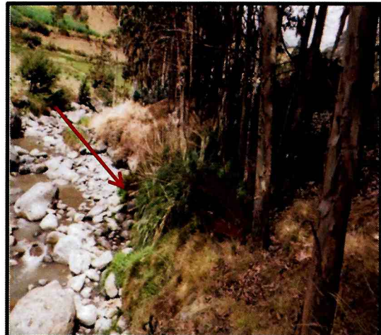
Fotografía N° 08: 137592FCVD04, Vertimiento del sistema de tratamiento de las aguas residuales domésticas de la ciudad de Marca, ubicado en la margen izquierda del río Marca.
