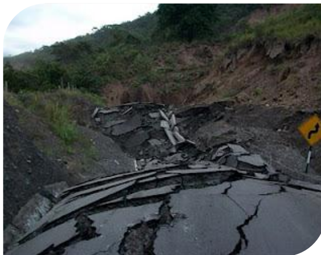
Pista destruida por movimiento sísmico
