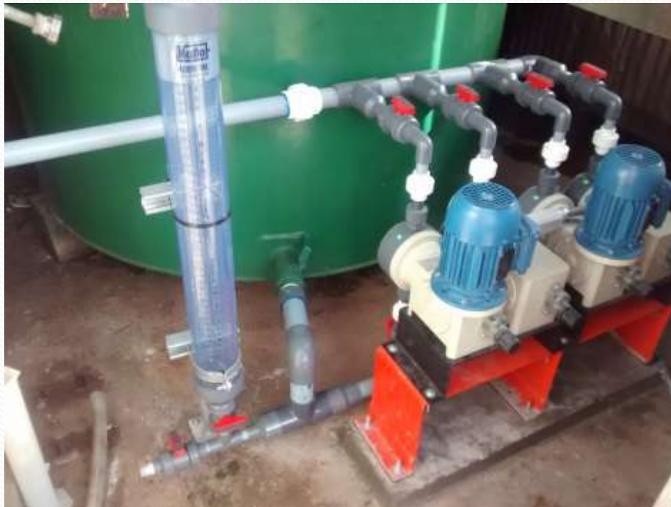
SISITEMA DE DOSIFICACION DE FLOCULANTE
