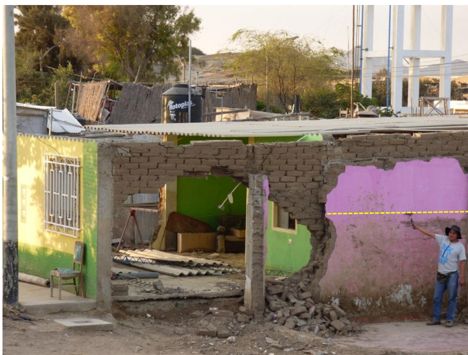
Foto 2. Rastrs del nivel de agua alcanzada por la inundación fluvial en los asentamientos humanos Cacique de Lloc y Ontere Giura. Distrito San Pedro de Lloc, provincia Pacasmayo, La Libertad.
