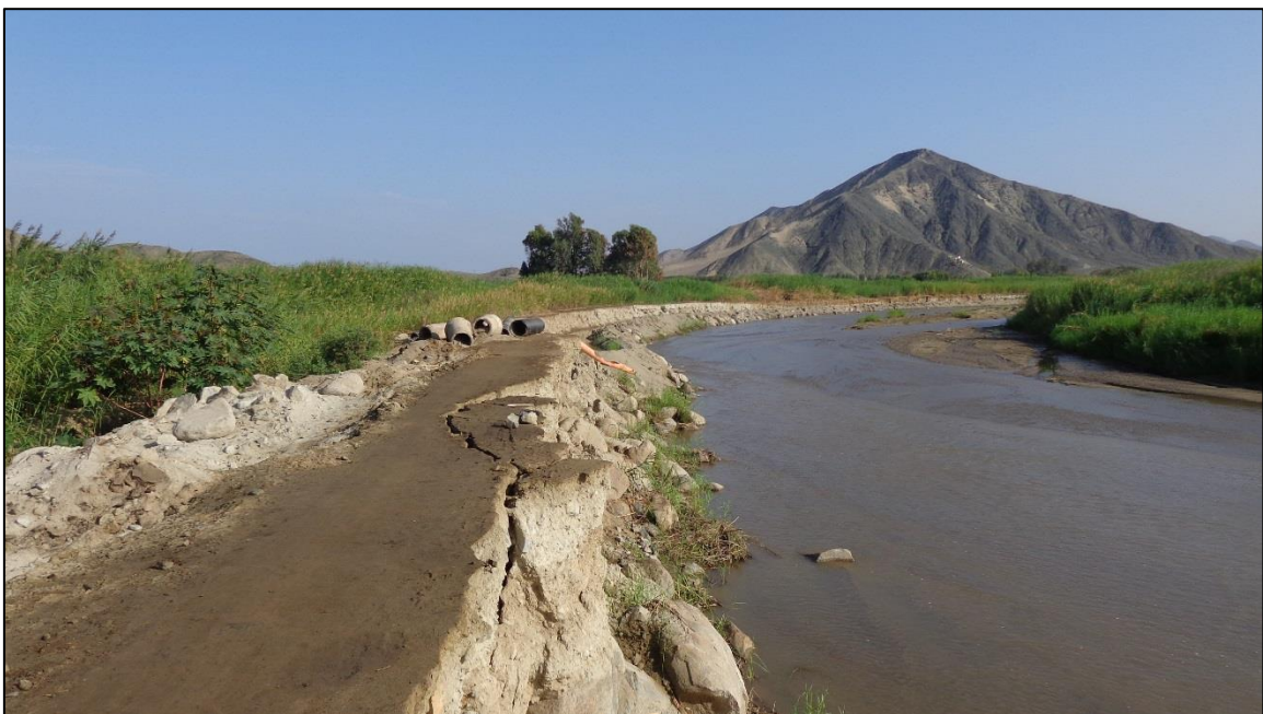
Foto 24. Trocha carrozable inhabilitada a causa de la erosión fluvial provocada por el río Huamanzaña. Hacienda Laramie, distrito Chao. Vista al NO.
