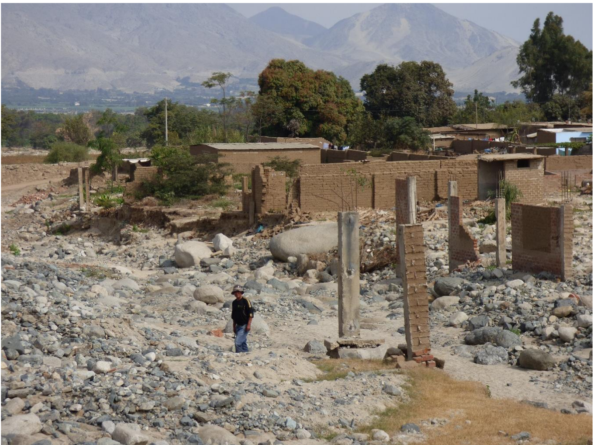
Foto 6. Viviendas destruidas por erosión fluvial, causado por la activación de la quebrada San Carlos en el distrito Laredo, provincia Trujillo, La Libertad.
