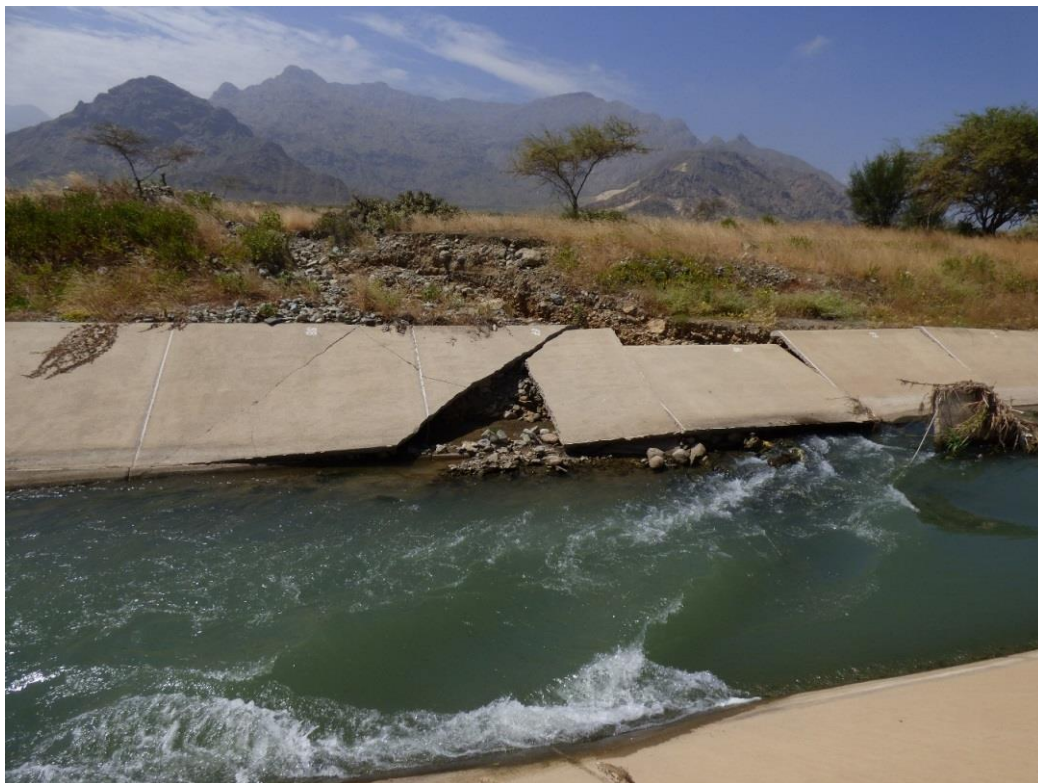
Foto 30. Erosión fluvial que afectó canal de riego Jequetepeque – Zaña en el sector Morona Alta. Distrito y provincia Chepen, La Libertad.
