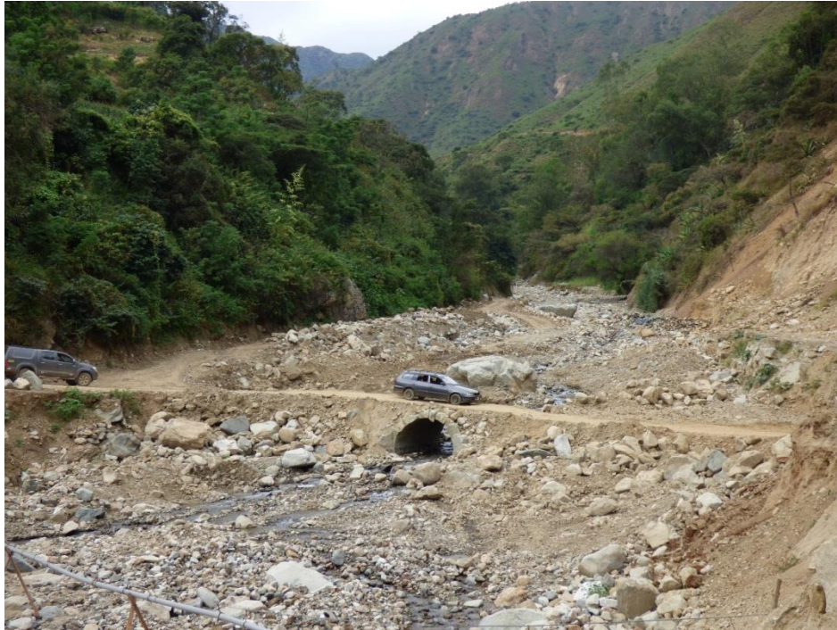
Foto 18. Flujo de detritos excepcional sobrepasó la capacidad del puente en la quebrada Chimbiles, carretera Cascas – Contumazá. Distrito Cascas, provincia Gran Chimú, La Libertad.
