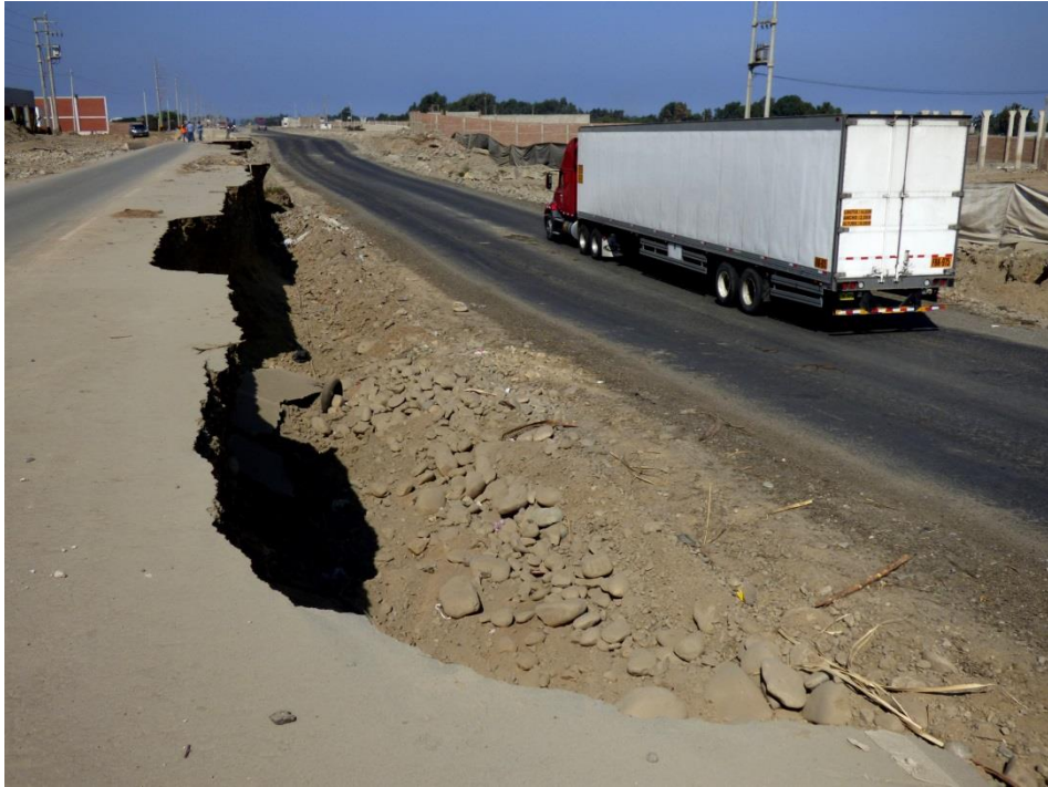
Foto 20. Erosión fluvial en la carpeta asfáltica en la vía circunvalación de la ciudad de Trujillo. Distrito Huanchaco.
