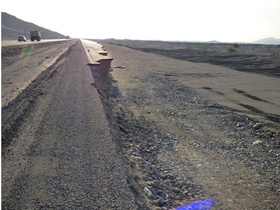
Foto 21. Erosión fluvial de la carpeta asfáltica en el Km 661, carretera Panamericana Norte. Distrito de San Pedro de Lloc, provincia Pacasmayo, La Libertad.
