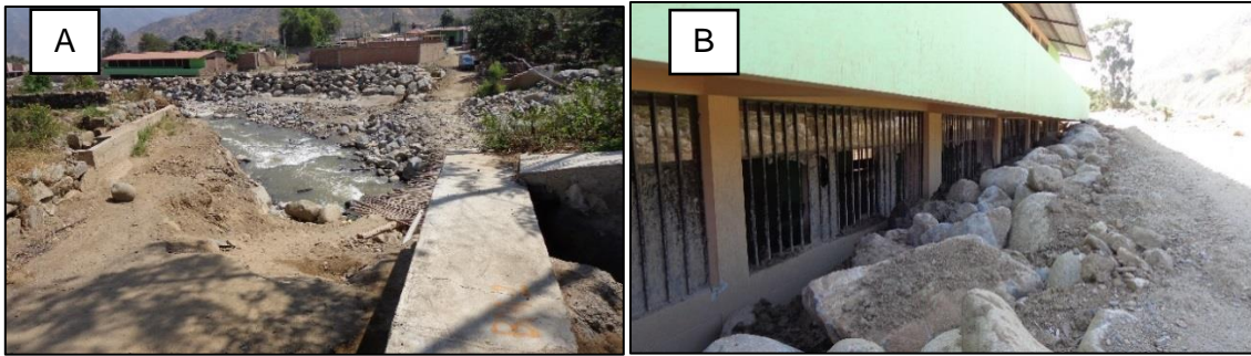
Foto 10. A) Foto panorámica del río La Cuesta. La crecida del río ocasionó daños en tuberías de agua potable e inundó las viviendas aledañas, así también causó la destrucción de camino rural. Vista al SO. B) Local multiusos del Pedregal afectado por la inundación a causa del desborde del río La Cuesta, obsérvese el nivel del material arrastrado por la corriente del río. Localidad del Pedregal, distrito Simbal. Vista al Sur.
