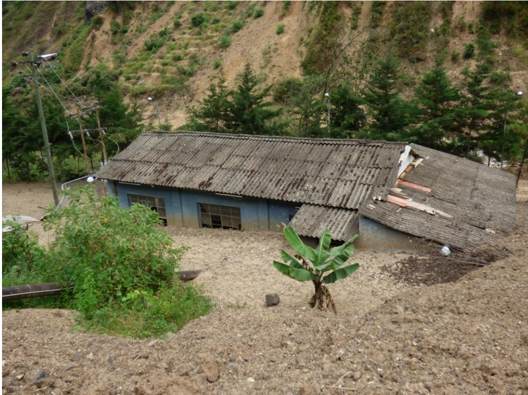
Foto 29. Mini central hidroeléctrica en desuso afectado por flujos provenientes del cerro Rumán en el distrito Cascas, Provincia Gran Chimú, La Libertad.
