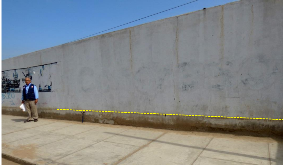
Foto 3. Rastros de nivel de agua alcanzada por inundación en las calles del distrito Víctor Larco Herrera; provincia Trujillo, La Libertad.
