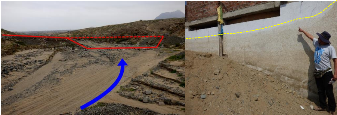
Foto 5. A). Rotura de dique transversal en el cauce de la quebrada San Idelfonso, Trujillo. B). Huellas del nivel de agua alcanzada por inundación en las calles del distrito El Porvenir, en la ciudad de Trujillo.
