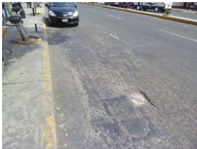
Foto 11 Estado de las vías baches, piel de cocodrilo, fisuras y ahuellamiento
