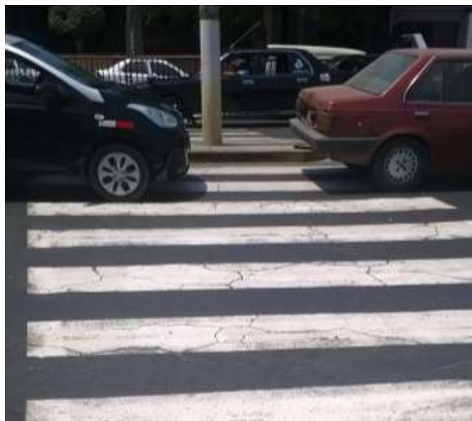
Foto 12. Fisuras en la carpeta asfáltica
