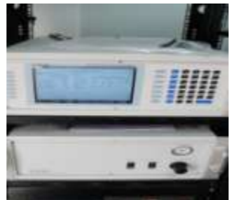
Sistema de Calibración de gases
